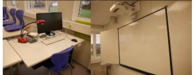
In jedem Klassen- und Fachraum eine Dokumentenkamera, ein digitales Whiteboard mit Beamer, LAN und WLAN
